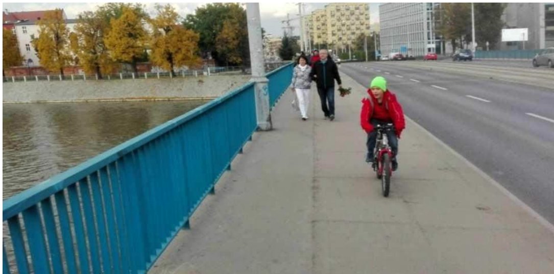
Rysunek 16 Miejsce po zdemontowanej barierze na drodze dla pieszych i rowerzystów - Mostu Pokoju we Wrocławiu
